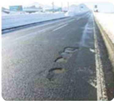
路面の穴ぼこ・ 段差
