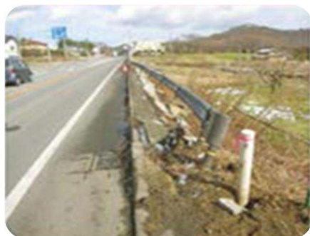
ガードレール・ 標識等の損傷
