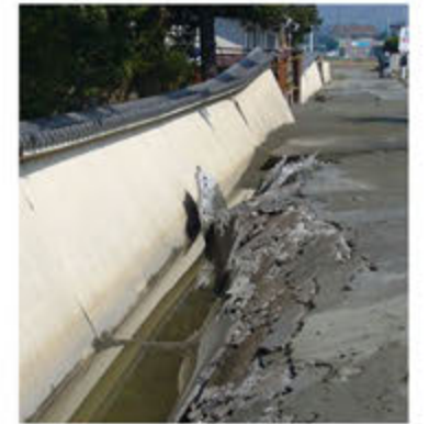
建物や外構等が傾きます。
