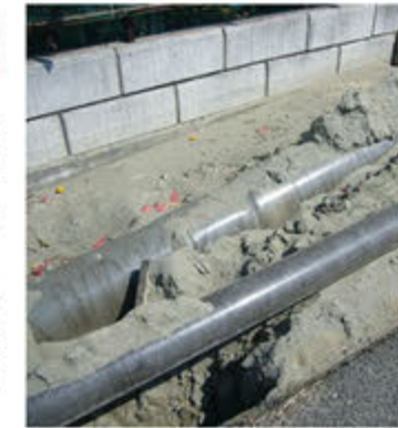
地面から泥水が噴き出したり、地中管等が浮き上がります。
