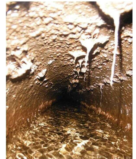
敷設集水管内部 全面に付着
