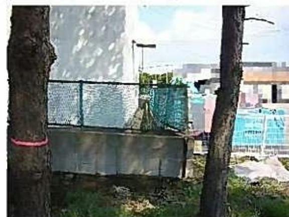
写真 1.4-28 側方流動によるブロック塀の変形
