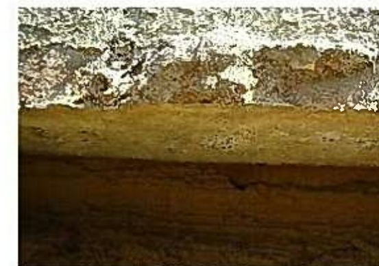
写真 2.1-3 沈下部のアップ
