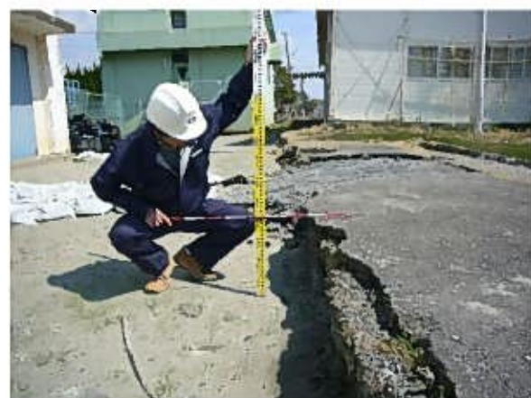
写真 1. 4-19 ボックスカルバート部の段差 40cm
