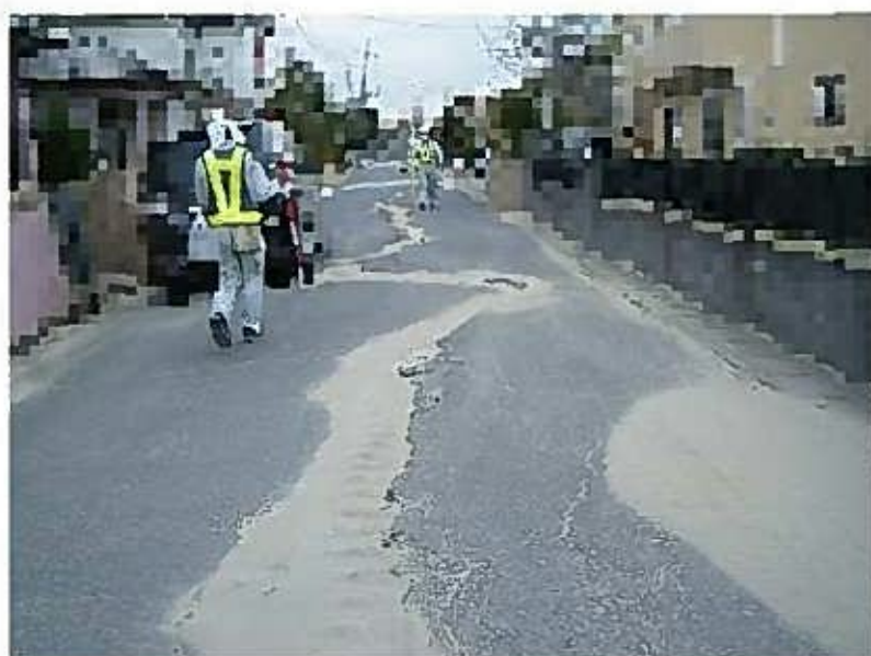
写真 1.4-6 現地の噴砂孔の写真(2011 年 4 月 16 日撮影)
