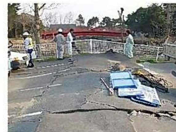
写真 1.4-30 雨水管ぎよの浮上り
