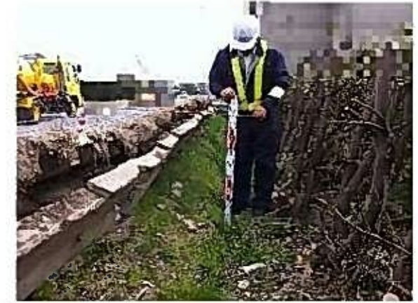
写真 1.4-11 雨水排水路の被害状況(1)
