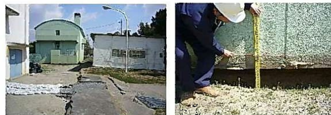
写真 2.1-2 雨水ポンプ場の地盤の沈下状況
