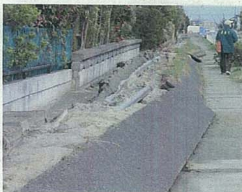
【歩道の埋設配管の浮上がり】 (茨城県潮来市)
