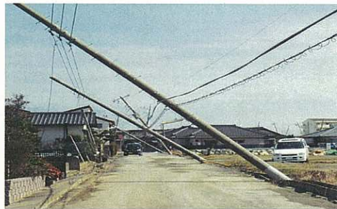
【大きく傾いた電柱】
