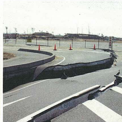
【陥没と亀裂の入った道路】
