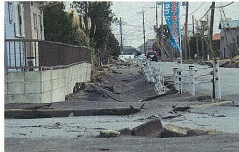
【陥没した歩道】
