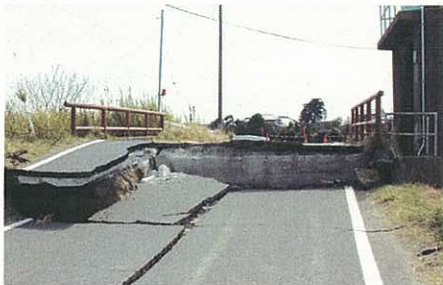
【陥没により通行止めになった箇所】
