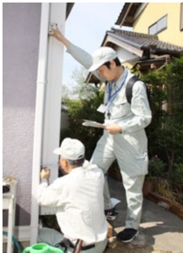
住宅被害認定調査
