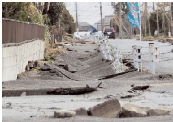
地盤沈下した歩道
