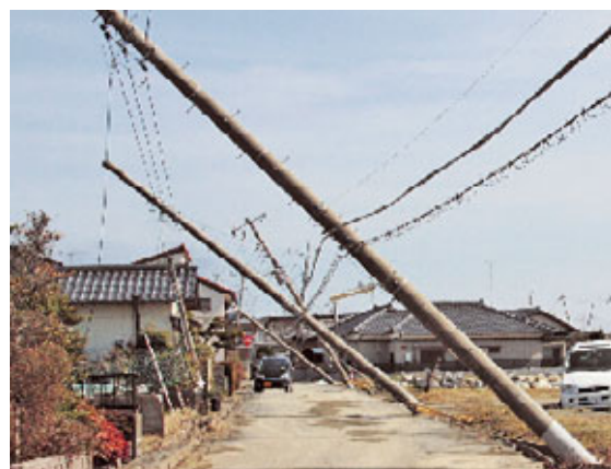
大きく傾いた電信柱
