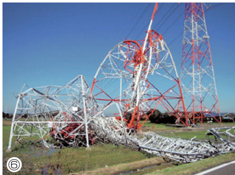
▲台風21号により鉄塔倒壊
