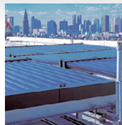
大学校舎の屋上に設置された太陽集熱器
